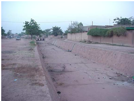
Photo 1: Réalisation de Faso Baara datant de 1995. Canal au secteur 19 à Ouagadougou construit en HIMO (creusement du canal par la MO locale, fond du canal en BA et berges en maçonnerie de moellons). Utilisation de pierres de Legma transportées par train de Bobo-Dioulasso à Ouagadougou.
