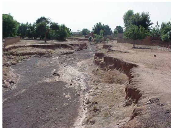
Photo 2: Situation en aval du pont-dalot, montrant l'érosion causée par un écoulement très fort lors de la saison des pluies.
