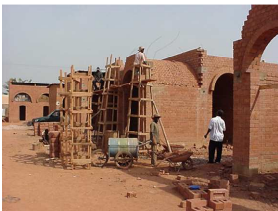
Photo 1: Construction du marché central de Koudougou comprenant 1210 boutiques, dont 755 déjà achevées et 619 étals à construire, utilisant des briques en terre comprimée.
